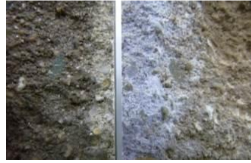
図-6 中性化によって地色のままの部分(左)と塩化物イオンの浸透によって白色に呈色した部分(右)の比較
