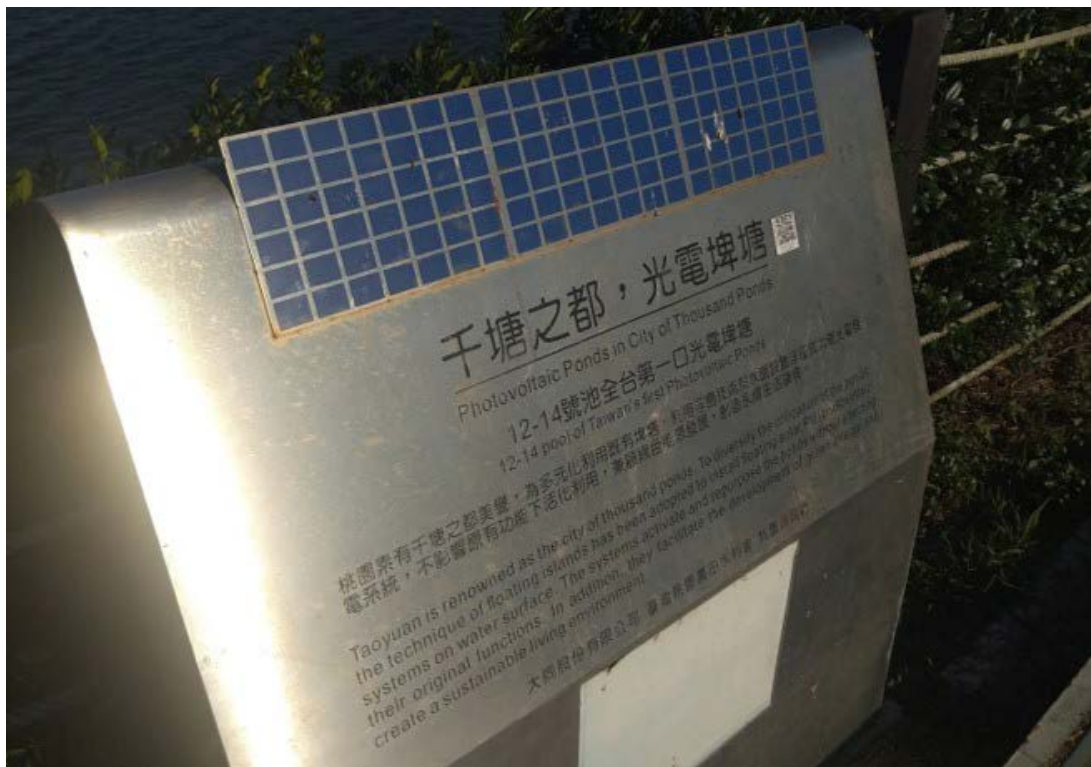
写真5 「千塘之都 光電埤塘」——台湾初となるため池水面型太陽光発電施設。
