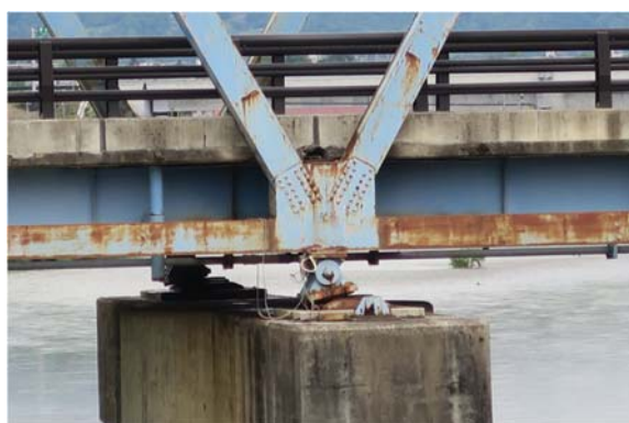
写真-1 伊達橋の被害状況
