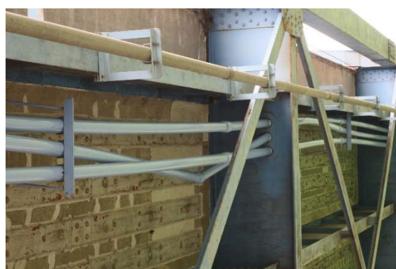
写真-2 伊達橋の添架管路被害
