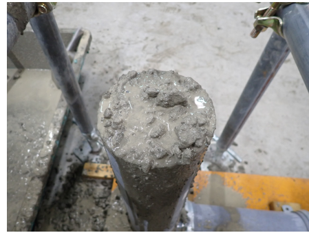
図-5 鉛直曲管により閉塞した分離コンクリート
