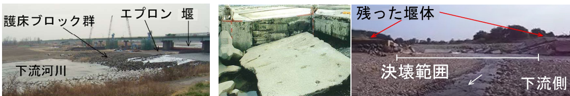
図 1 河床低下で護床が傾斜化した堰（左）と被災例（中：エプロン陥没、右：堰決壊）
