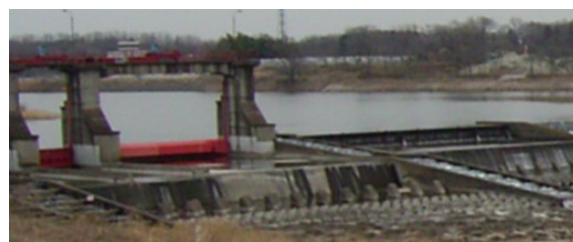
図9 堰直下流での段差発生事例
