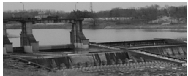
図-1 堰直下の段差発生事例
