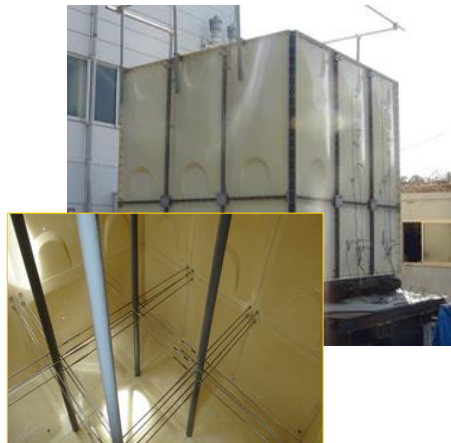
写真-3 FRP製パネルタンク (FRPタンク)
