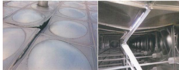
(b) 天井部の割れ (c) 内部補強部材の損傷
