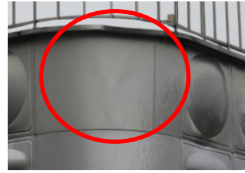
(a) 隅角部上部の損傷
