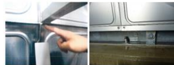
(c) 溶接部のクラック (d) 補修後も続く水漏れ
