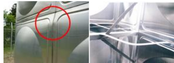
(a) タンク下部での被害 (b) 内部補強材の座屈
