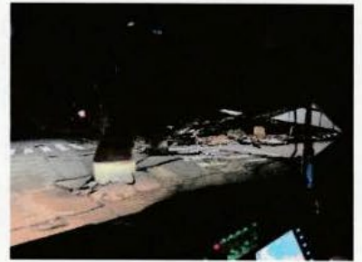
地盤沈下によって隆起したマンホール
