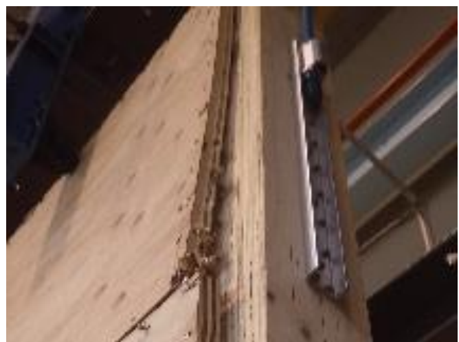
図5 梁にLVLを用いた場合の面材の浮き (L28-02) (-1/15 (rad)時)
