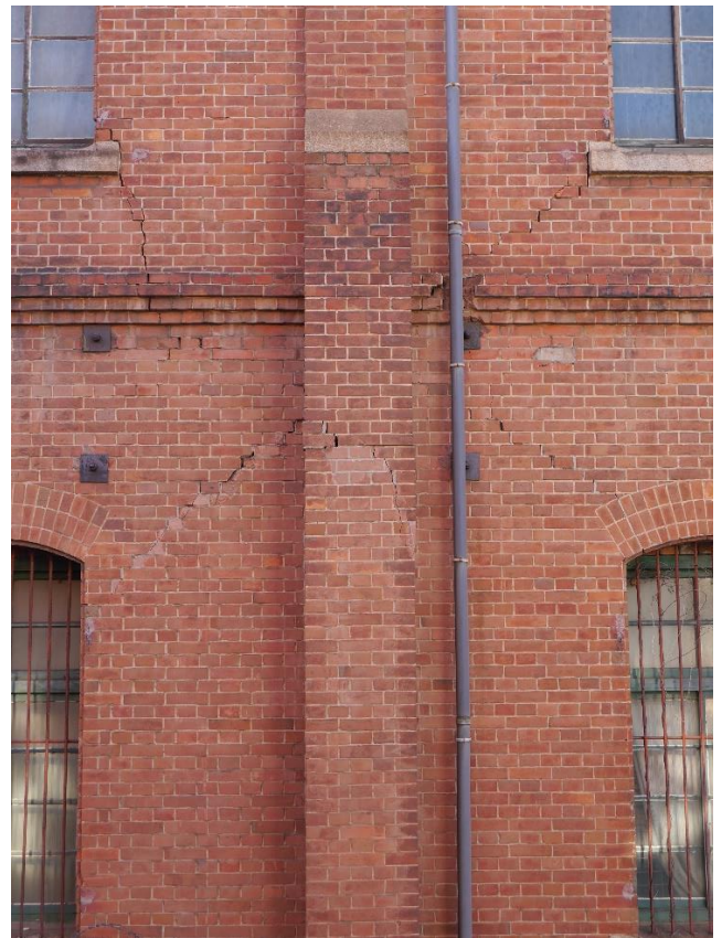
図6 第八庫東北側の外壁・バットレスのひび割れ
