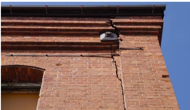
図 12 現在の第九庫南西隅の外壁ひび割れ
