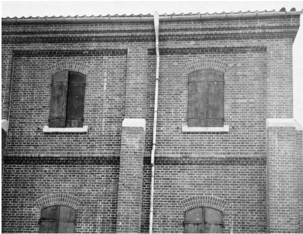
図7 東北側壁封角線状亀裂(47)ノ外部 注2)
