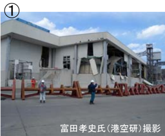
① 富田孝史氏(港空研)撮影 ふ頭上の建物の被害
