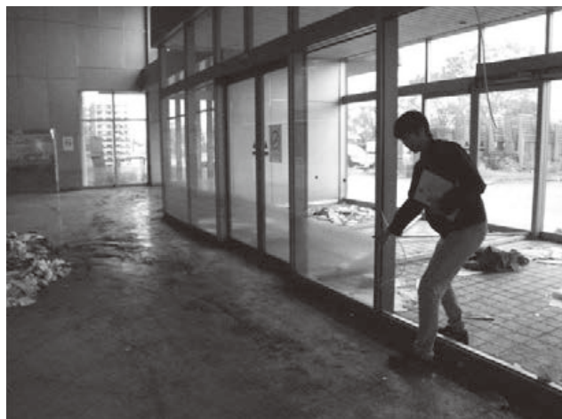
図表1 高潮の浸水痕跡(神戸市東灘区向洋町東)
