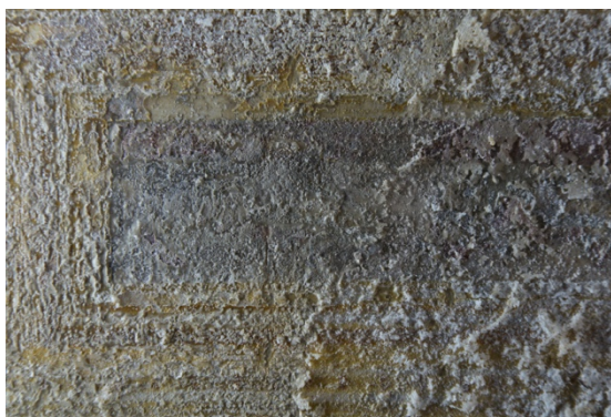
写真3 旧補強剤の層を突き破り結晶化した塩
