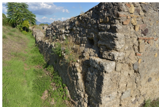
写真2 アポロの家 外壁の様子
