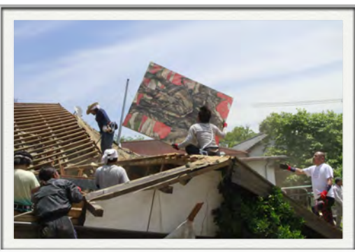
地震で倒壊したアトリエから田中憲一作品を救出する 市民と震災ボランティア(2016年熊本県御船町)
